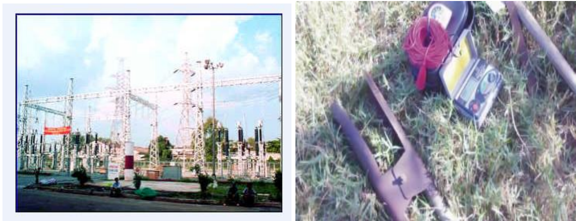
Hình 0.1 Trạm biến áp và Khu thực nghiệm nối đất
